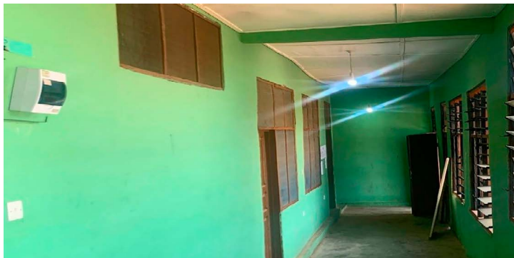
De elektriciteit is aangelegd voor de verlichting en de ventilatoren.
